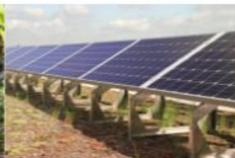
Förderprogramme Klima. Photovoltaik
